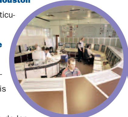
Centre de contrôle de Redu
